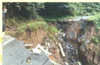
2020年7月の豪雨による道路崩落
